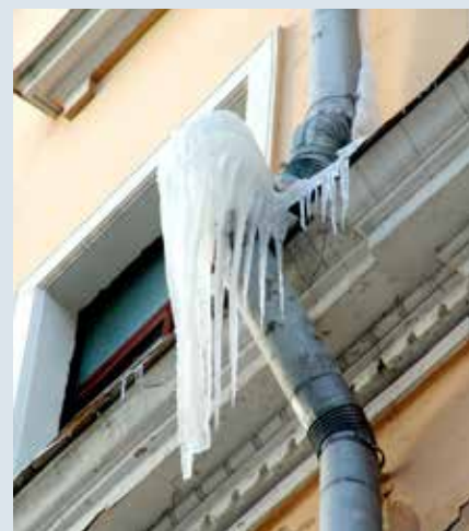
Joon. 2-14 Külmumisest tingitud purunemine
